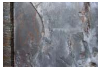
塩害による 腐食の防止がしたい
