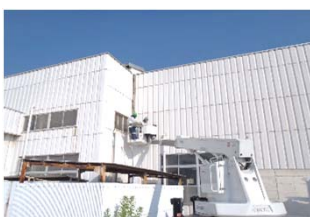
ススや排気ガスで 外壁が黒ずむ
